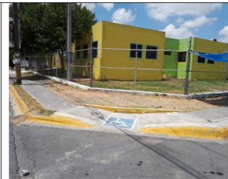
FOTOGRAFIA 02 Rampa para personas con discapacidad fuera del Jardín de Niños frente al costado Sur del predio, calle N 27 esq. Av. Metroplex.
