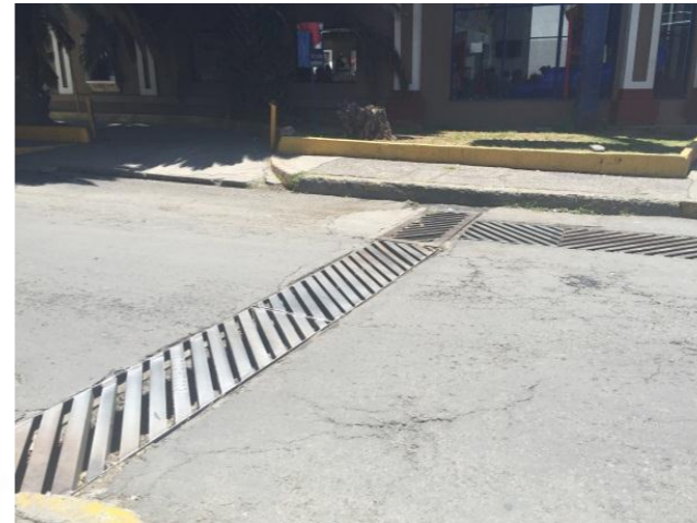
Alcantarillado calle Benito Juárez.
