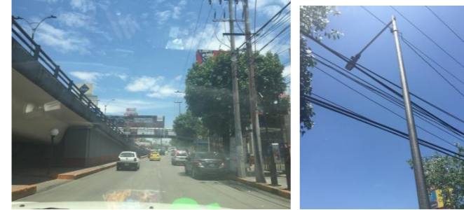
Líneas de alta tensión, baja tensión y alumbrado en Avenida José López Portillo.
