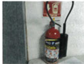
Extintores SITE Centro Moras Piso 2
