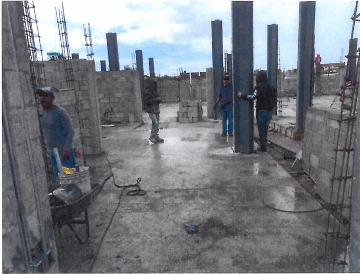
Por motivo de las lluvias, se suspenden los trabajos de cimbrado y colado de castillos
