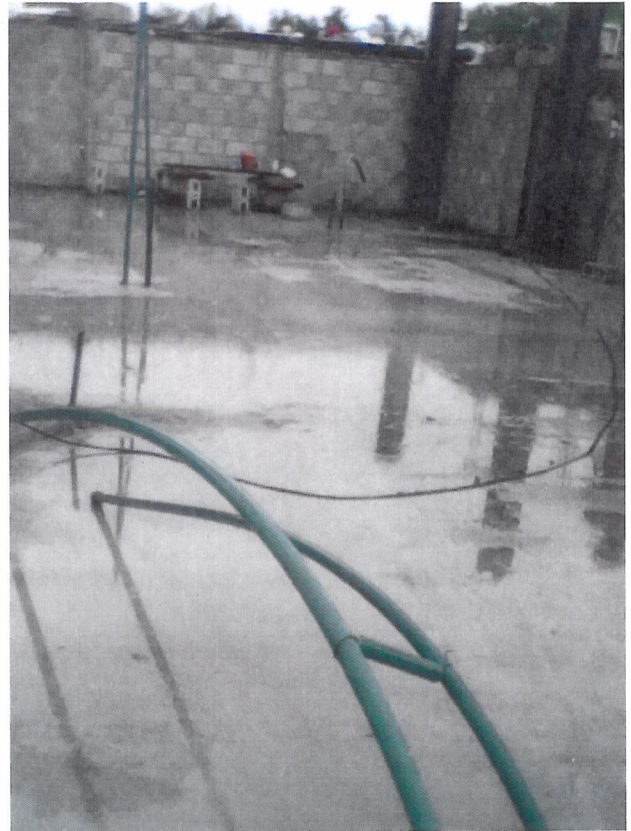
Debido a que el agua, es un elemento de conductividad electrica, se suspenden los trabajos de instalaciones para salvaguardar la integridad de los trabajadores y evitar que debido a la electricidad que se usa en las herramientas de estos equipos provoque un accidente.
