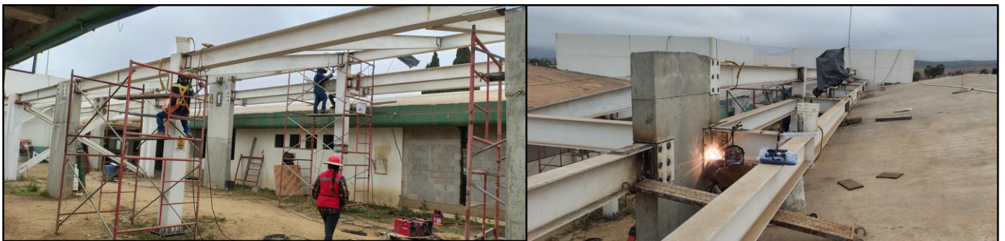
Trabajos de retiro y restitución de soldadura en estructura metálica de Cuerpo 2.
