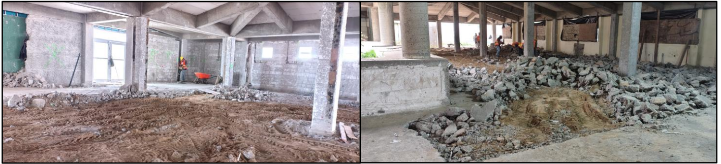
Demolición de firmes de concreto y retiro del material producto de las demoliciones.
