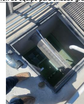
Inst. de filtros PTAR.
