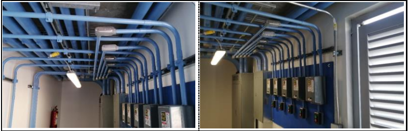
TUBERIA PARA FUERZA EN CUARTO ELECTRICO DE AZOTEA.
