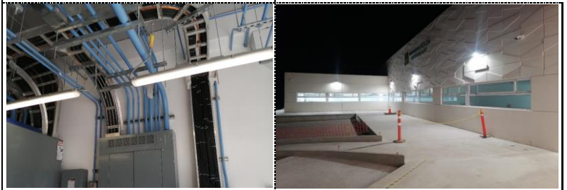
TUBERIA PARA ALIMENTADORES EN CASA DE MAQUINAS.
