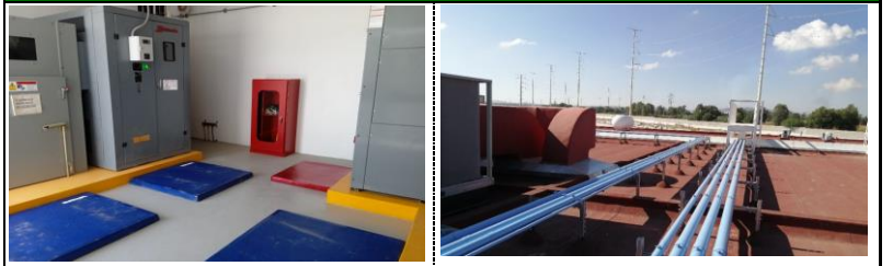
EQUIPAMIENTO CASA DE MAQUINAS.
