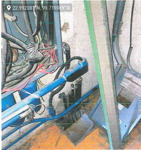
Existen equipos eléctricos con elementos expuestos y sin tapas en algunos casos.
