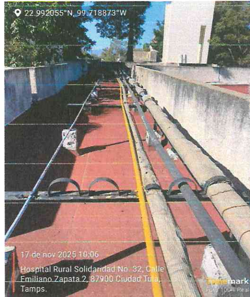
Las tuberías de cableado se encuentran en buen estado y están fijadas correctamente.
