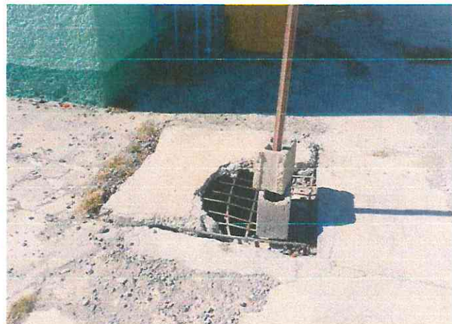
Existen varios registros sanitarios que tienen la tapa rota con la malla de acero expuesta, es recomendable volver a hacer y colocarlas debidamente.
