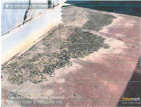
Existen residuos sueltos en la losa como gravilla, la cual debe ser removida.
