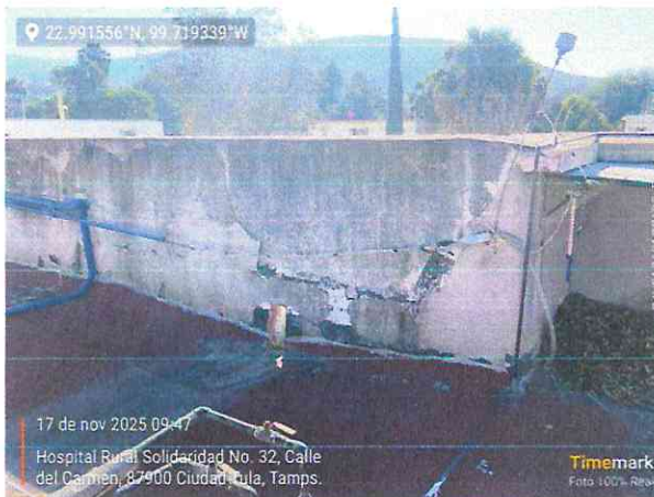
Existen grietas superficiales en algunos pretilos de la azotea.
