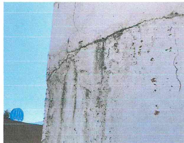
Se perciben grietas horizontales en esquinas y límites de los pretilos, las cuales podrían representar a largo plazo un problema estructural menor que genere desprendimientos.
