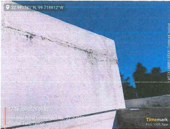
En azotea se perciben muros con presencia de humedad y grietas superficiales en las juntas de la losa y los pretilos.
