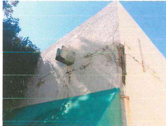
Al observar todos los muros, se observa solo un daño estructural importante que debe ser atendido, el cual es un desprendimiento en una esquina superior la cual deja el acero expuesto y puede debilitar la estructura.
