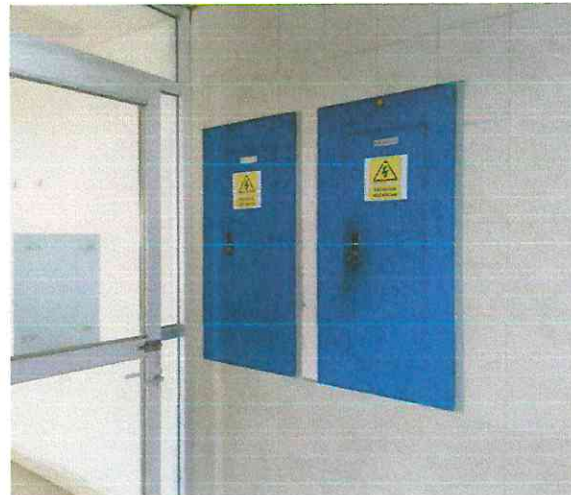
Los equipos eléctricos y los cuadros de carga del interior del edificio están en buen estado y cubiertos correctamente.
