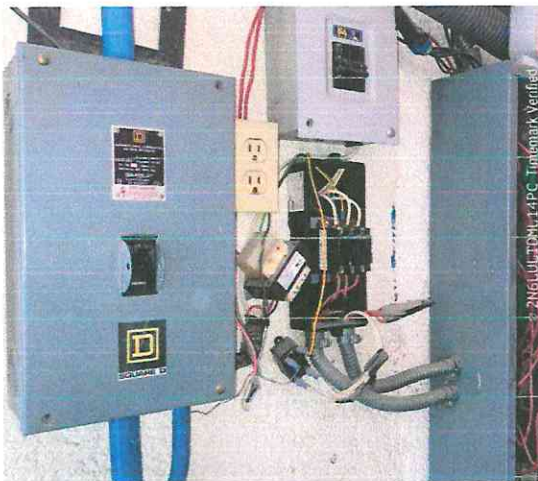
En áreas de azotea y mantenimiento los cuadros de carga carecen de tapas y los cableados están expuestos.
