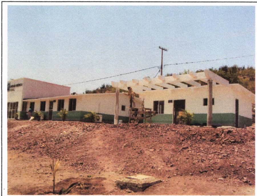
VISTA GENERAL DE LOS MUROS DE LAS DOS ESTRUCTURAS REVISADAS, SIN NINGUN TIPO DE DAÑO ESTRUCTURAL.
