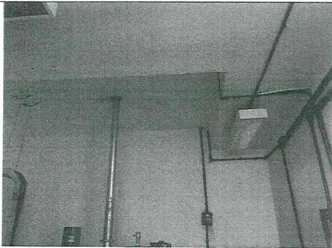
151. PLANTA DE EMERGENCIA
