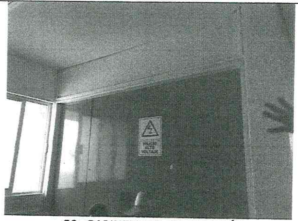
50. GABINETE DE ALTA TENSION
