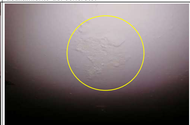
Fotografía 40. Hospitalización. Pasillo Urgencias Obsérvese abultamientos y eflorescencias en losa.
