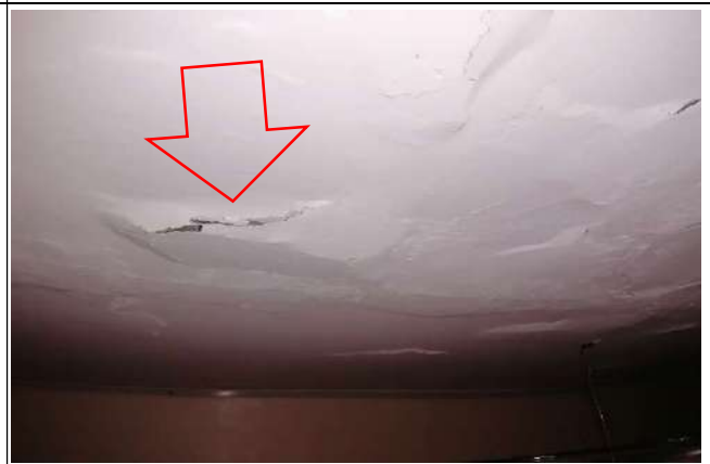
Fotografía 16. Gobierno. Pasillo Nótese hinchazón como paso previo al desprendimiento por astilladura del concreto.
