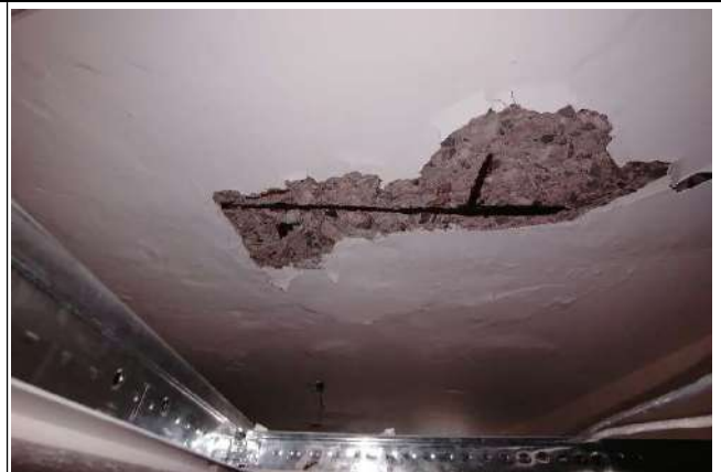
Fotografía 14. Gobierno. Pasillo Vista a detalle de la astilladura del concreto.
