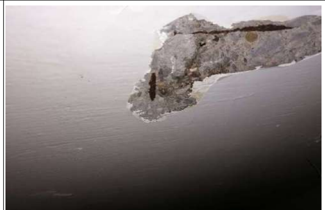
Fotografía 34. Hospitalización. Pasillo a Cocina. Acercamiento astilladura de losa por corrosión localizada del acero de refuerzo.
