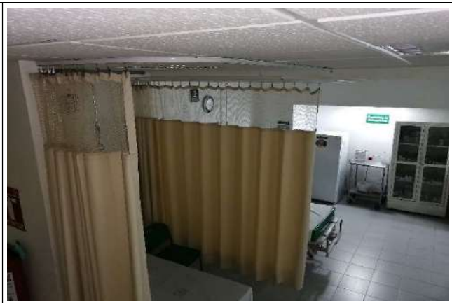
Fotografía 42. Hospitalización. Urgencias Pisos y muros sin detalles.
