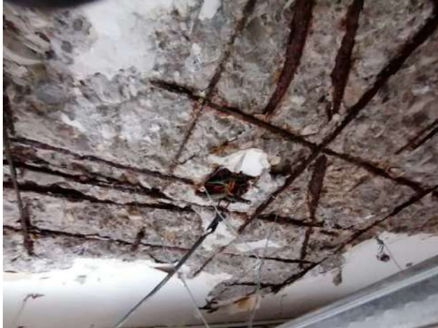
Fotografía j. Obsérvese corrosión de las tuberías y cajas de conexión Eléctrica y cableado sin protección.
