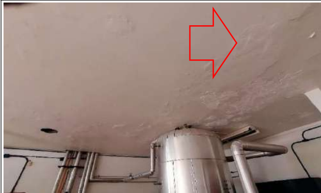
Fotografía 23. Servs. Grales. Cuarto de máquinas Nótase abultamientos e hinchamientos localizados en losa.
