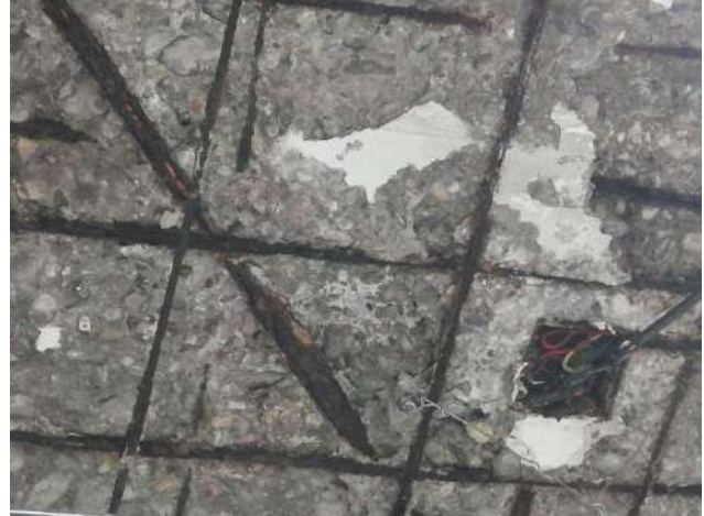
Fotografía k. Obsérvese corrosión de la instalación eléctrica y cableado sin protección.
