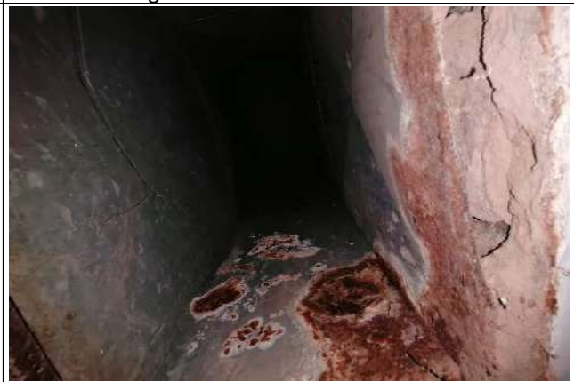
Fotografía 46. Hospitalización. Urgencias Vista a detalle del grado de corrosión que presenta el ducto de aire acondicionado.
