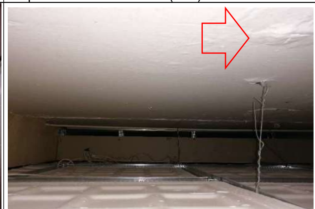
Fotografía 38. Hospitalización. Pasillo Urgencias Nótese hinchamiento de la losa previo a ruptura y astillamiento del concreto.
