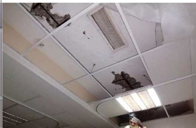
Fotografía 50. Hospitalización. Sala de labor Obsérvese las astilladuras y despasivación del acero de refuerzo por corrosión generalizada.
