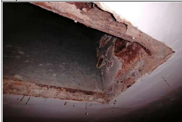
Fotografía 45. Hospitalización. Urgencias Nótese corrosión avanzada en ducto galvanizados de aire acondicionado ahogado en el concreto de losa.
