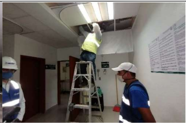
Fotografía 48. Hospitalización. Sala de labor Pisos y muros sin detalle. Inspección y auscultación de losa.
