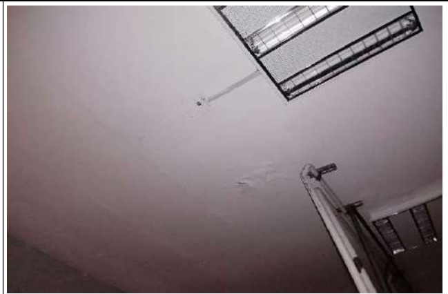
Fotografía 26. Servs. Grales. Lavandería Obsérvese abultamiento inicial en forma localizada en la losa plana.
