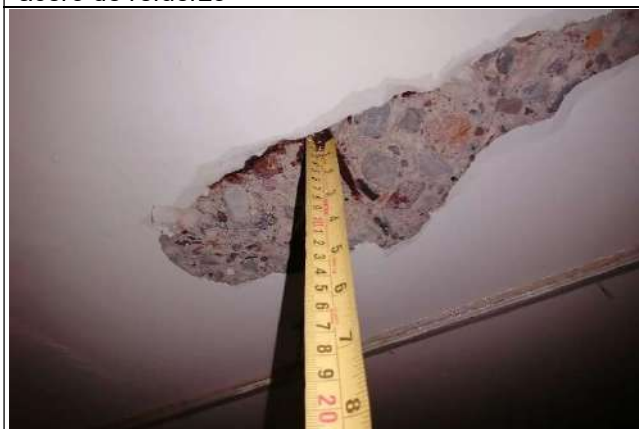
Fotografía 39. Hospitalización. Pasillo Urgencias Medición directa en astillamiento del recubrimiento del acero de refuerzo en losa.
