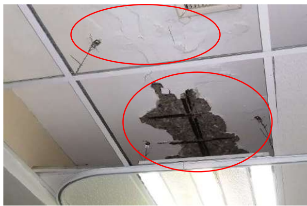
Fotografía 49. Hospitalización. Sala de labor Obsérvese astillamientos y fisuras por corrosión generalizada del acero de refuerzo.
