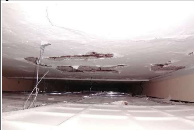
Fotografía 15. Gobierno. Pasillo Nótese astilladuras del concreto por corrosión generalizada del acero de refuerzo.
