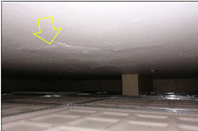
Fotografía 47. Hospitalización. Urgencias Nótese abultamientos en la losa en varios puntos.
