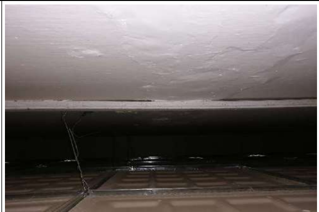
Fotografía 44. Hospitalización. Urgencias Obsérvese ligeros abultamientos en losa.
