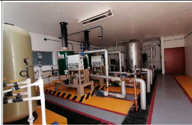
Fotografía 22. Servs. Gales. Cuarto de máquinas
