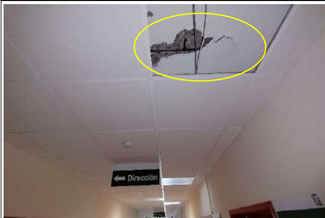
Fotografía 13. Gobierno. Pasillo Obsérvese astilladura del concreto por corrosión generalizada del acero de refuerzo.
