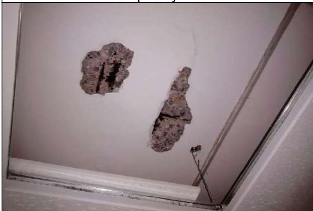
Fotografía 37. Hospitalización. Pasillo Urgencias Nótese astillamientos por corrosión localizada del acero de refuerzo
