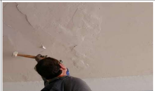
Fotografía 24. Servs. Grales. Cuarto de máquinas Auscultación mediante prueba de martillo de la losa. Nótase hinchamiento y desprendimiento en losa.
