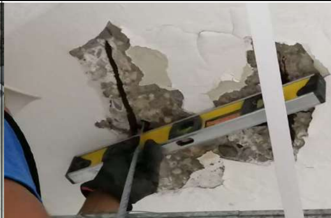
Fotografía 52. Hospitalización. Sala de labor Determinación de la profundidad del desprendimiento por astilladura en el concreto.
