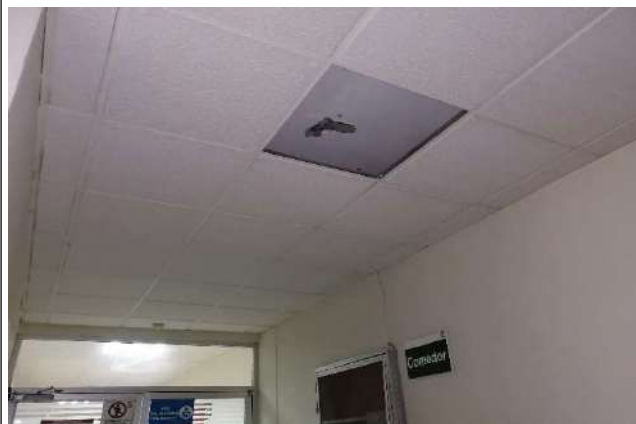
Fotografía 31. Hospitalización. Pasillo a Cocina Nótese Astillamiento en losa por corrosión localizada del acero de refuerzo.
