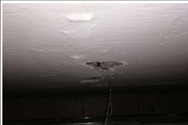
Fotografía 33. Hospitalización. Pasillo a Cocina. Astilladura por corrosión localizada del acero de refuerzo. Obsérvese abultamientos.
