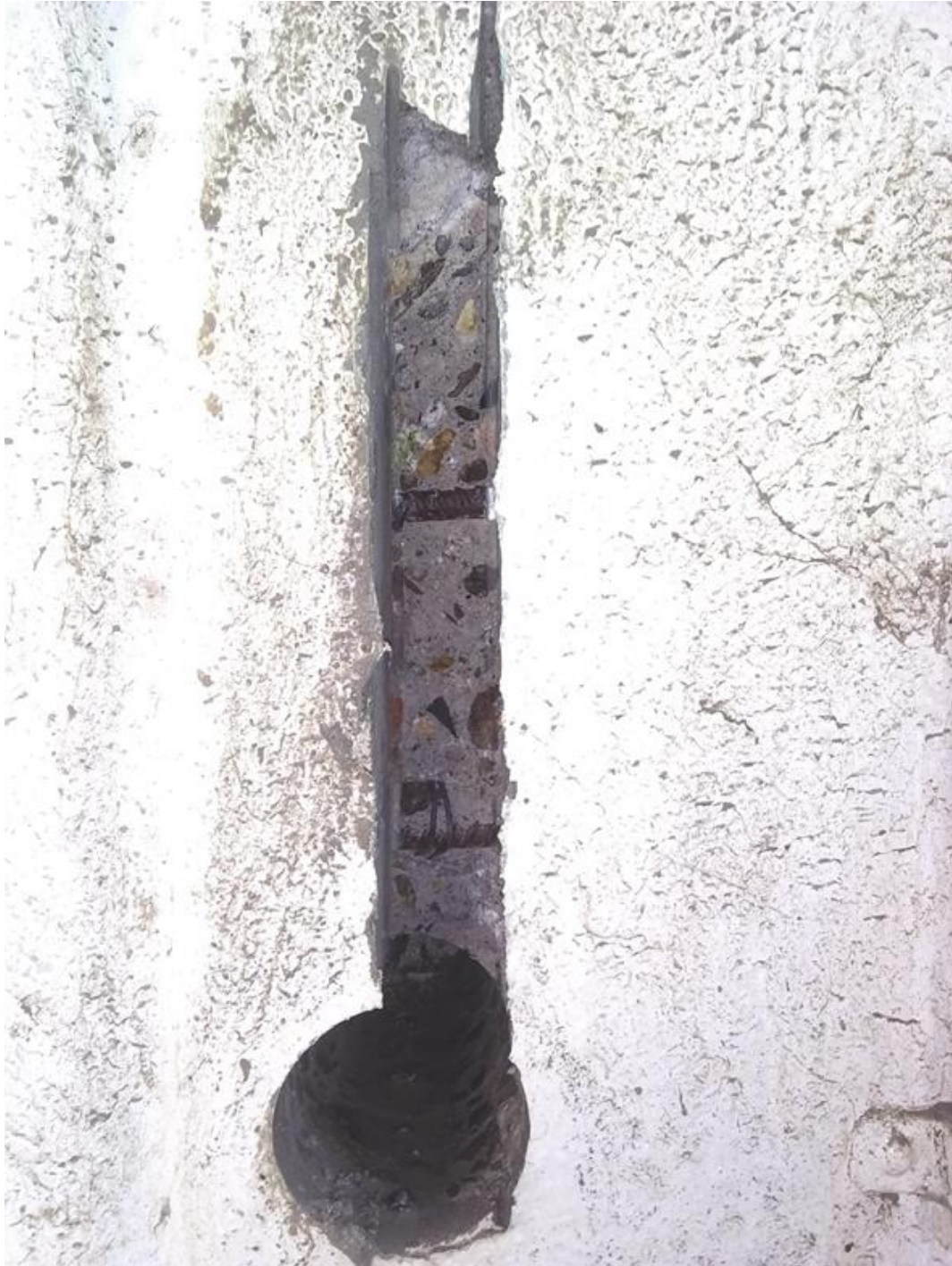
Vena en columna, se aprecia la separación de estribos del # 3
