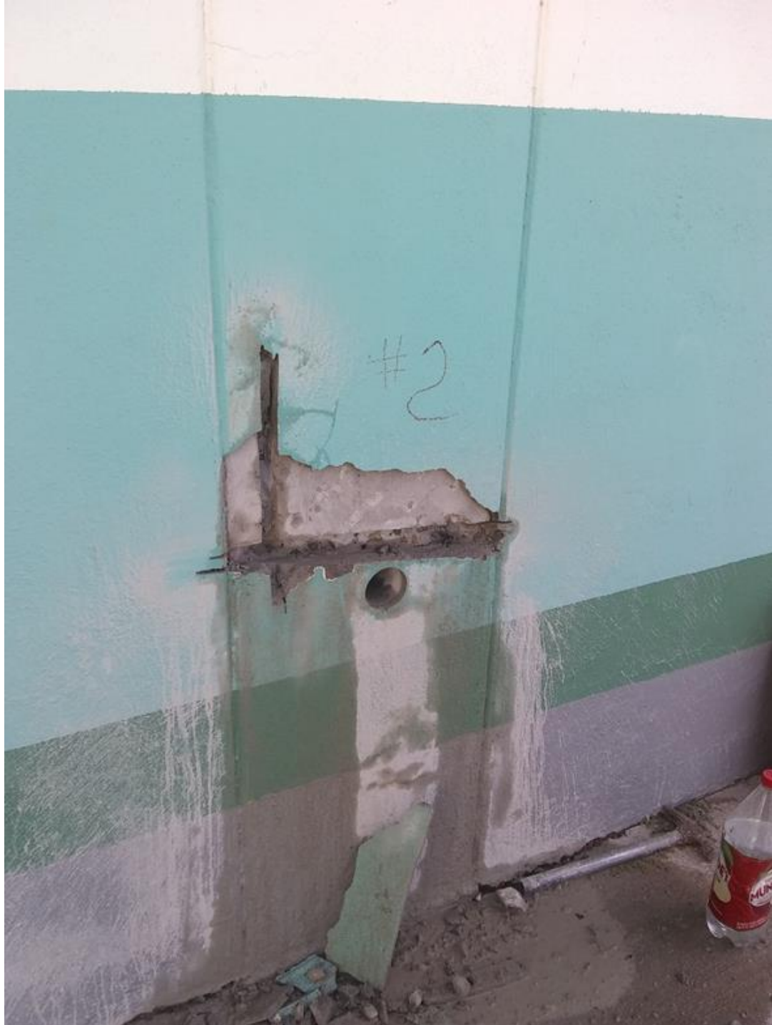
Vista de columna, realizando el mismo proceso para determinar el tipo de armado y su separación.
