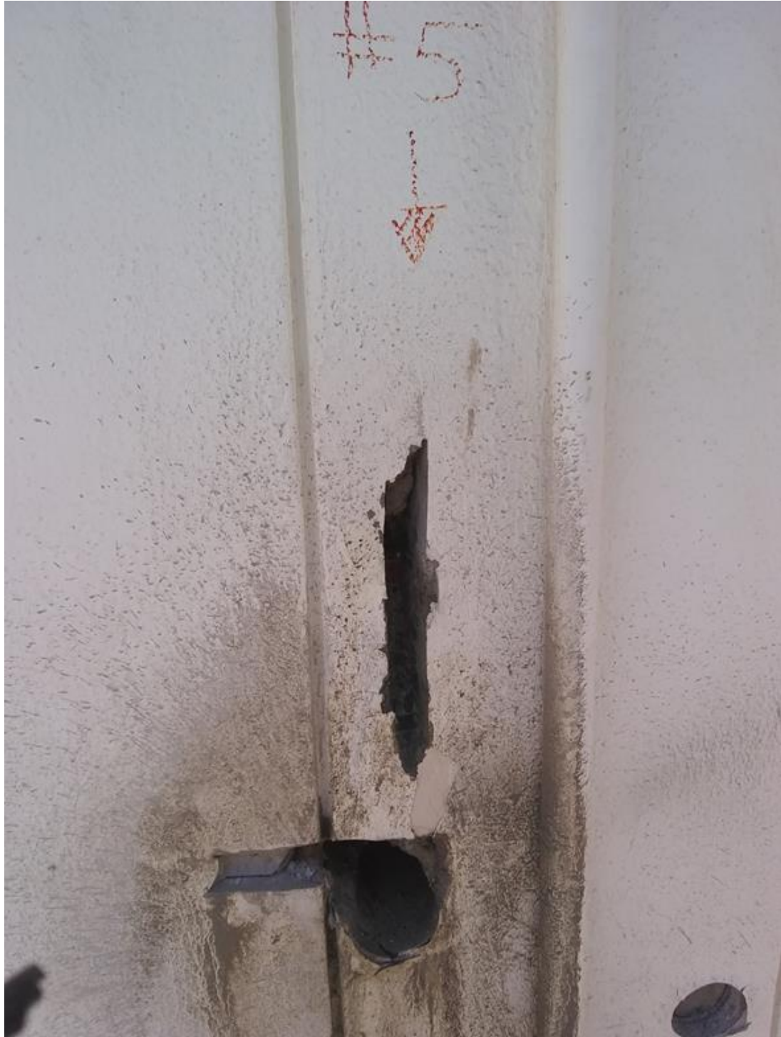
Vista de venas en columnas de junta constructiva
