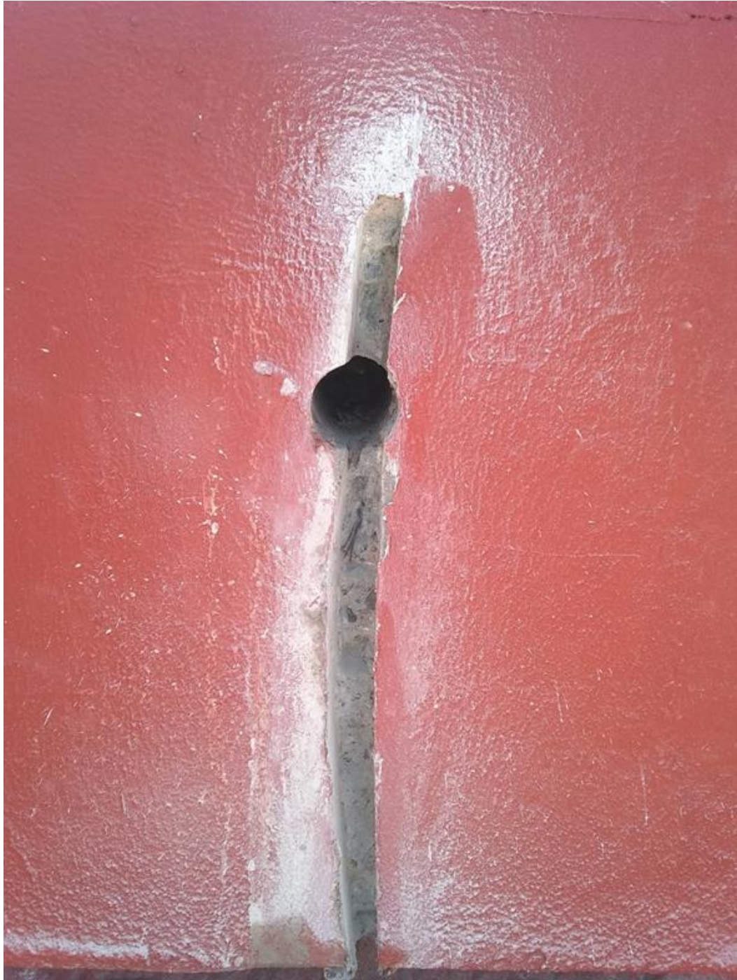
Vena efectuada en trabe, nótese que los estribos son de alambón
