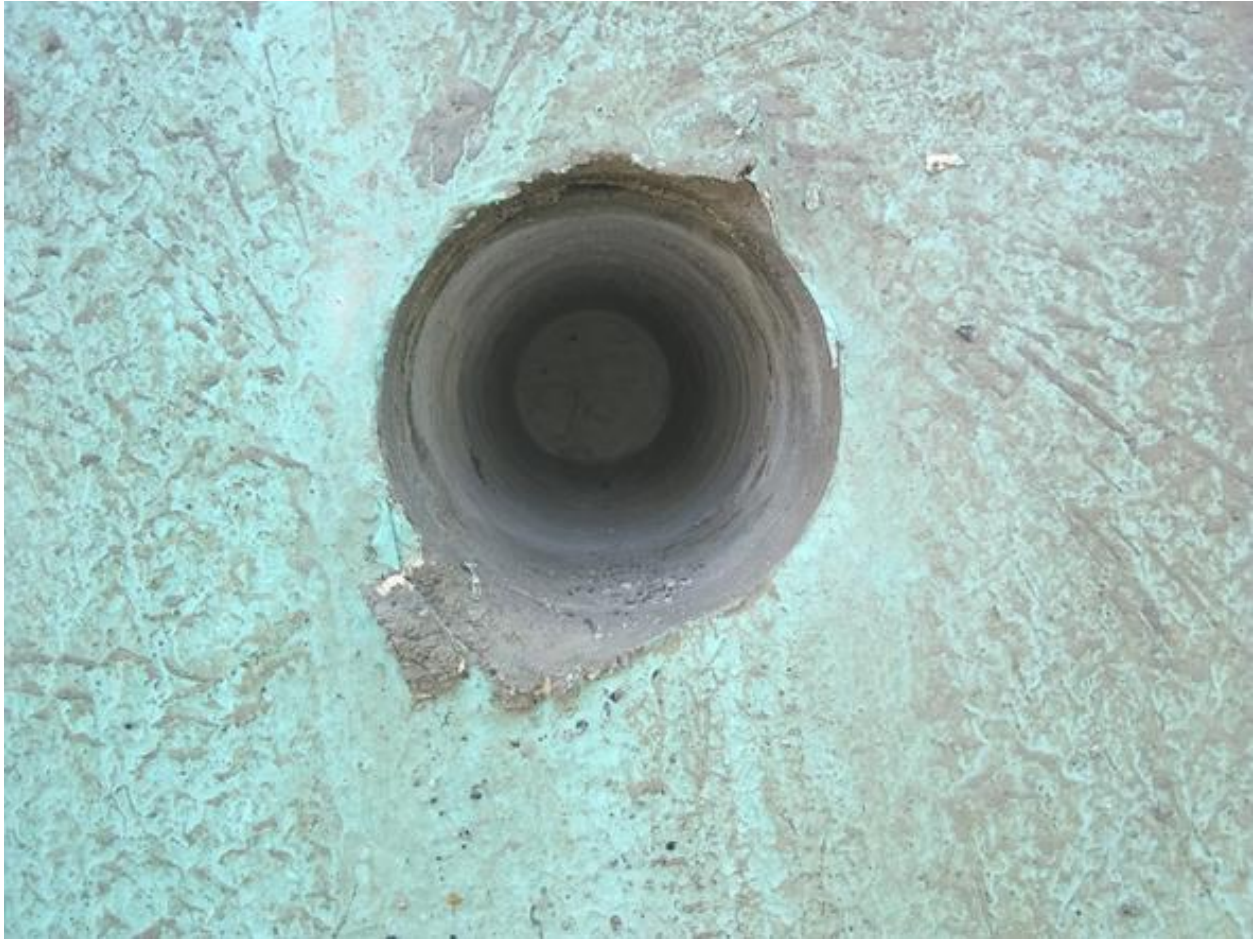
Vista del Orificio al retirar la probeta de concreto.
