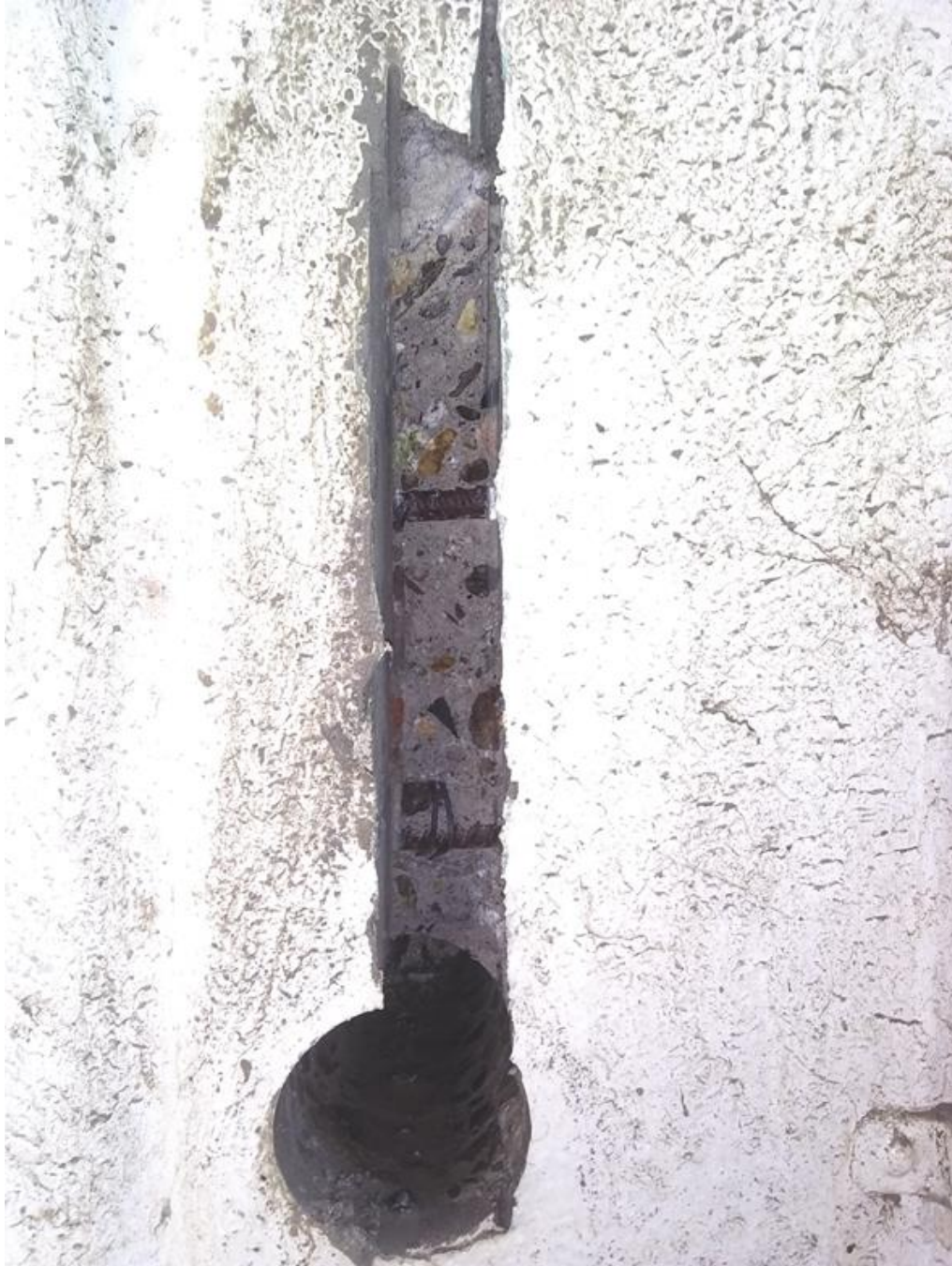
Vista de columna con las venas en donde se aprecia la separación de estribos
