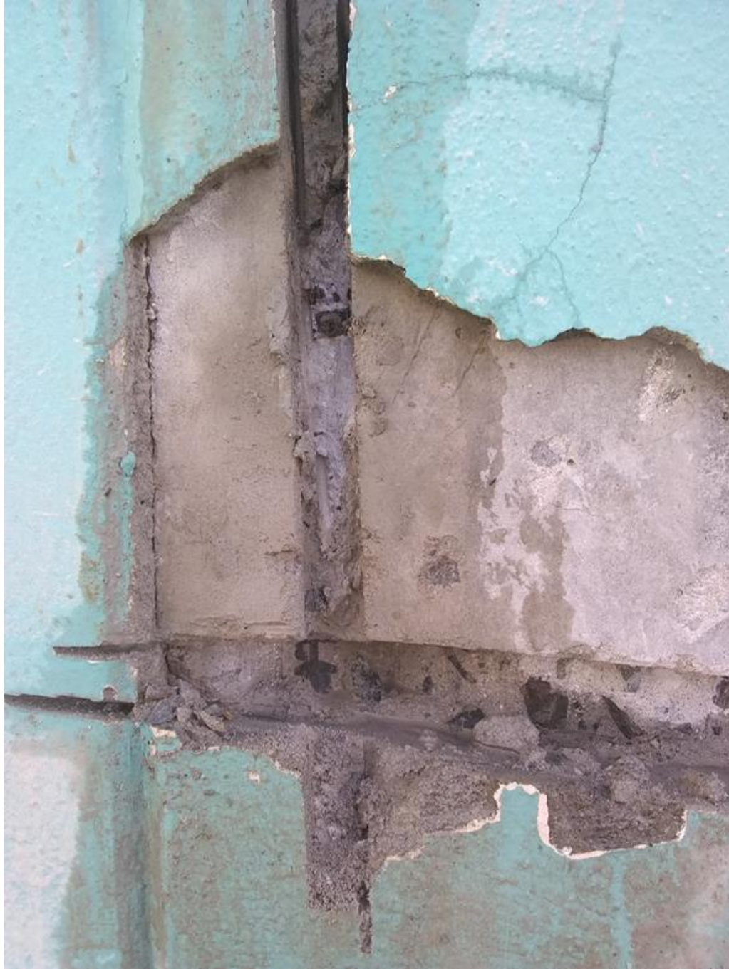
Vista del Acero de Refuerzo expuesto en columna.
