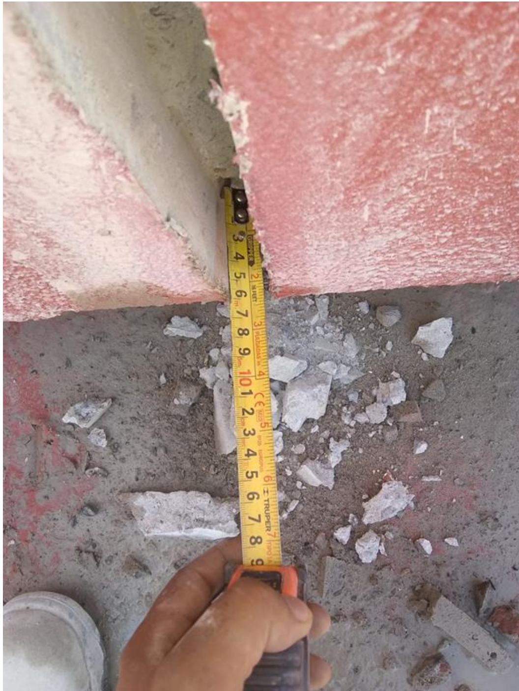
Vista de otra trabe en la misma zona, en donde se penetraron 6 cm y no se encontró el acero de refuerzo.
