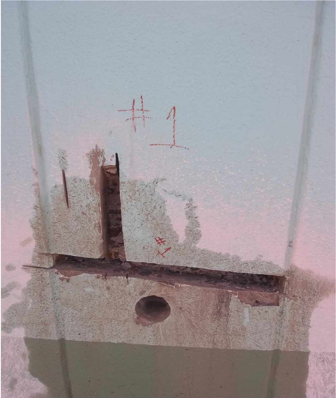
Columna en donde se aprecia el agujero de la probeta y la vena que se realizó para determinar el acero de refuerzo de la columna.
