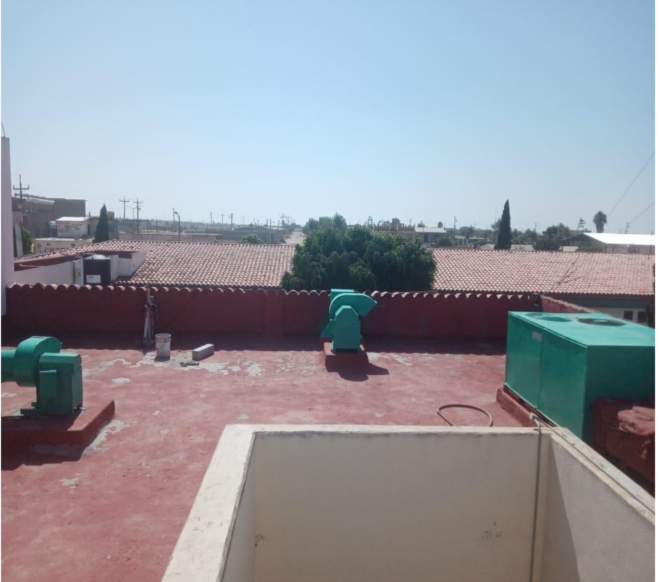
Al fondo se muestra trabe en donde se extrajo núcleo de concreto.
