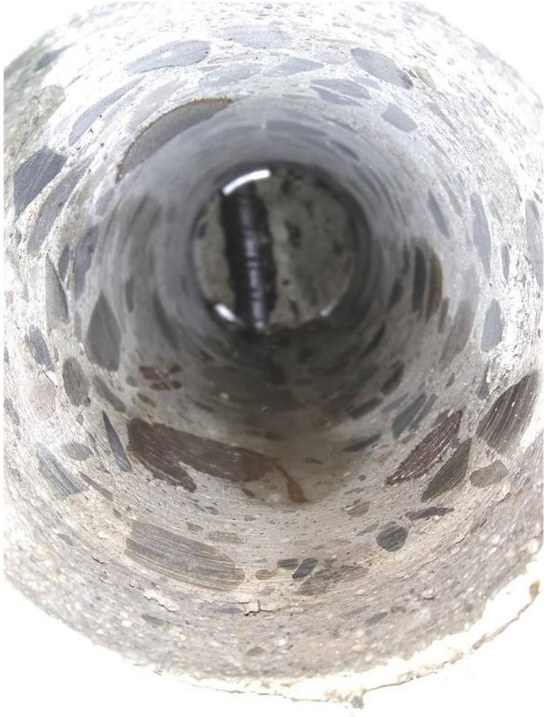
Vista de orificio para extraer la probeta de concreto, encontrándose el acero de refuerzo.
