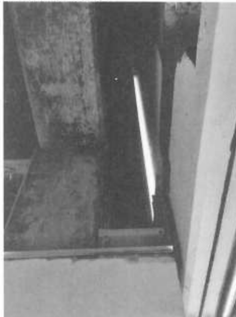
Figura 4. Separación con estructura colindante.
