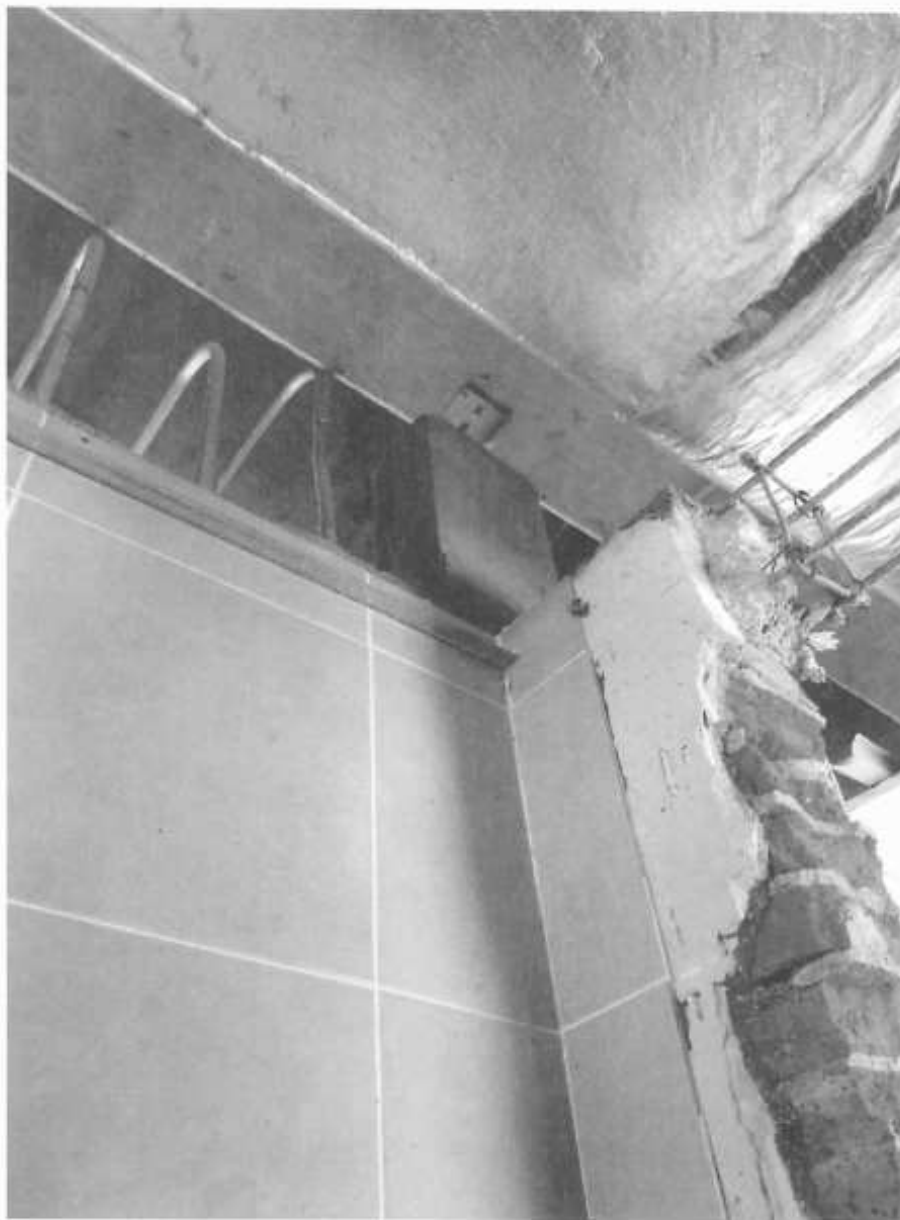
Fotografía 2. Muros desligados de la estructura principal, y sujetos con placa metálica en forma de Z para evitar el volteo; se demolieron algunos muros por cuestiones arquitectónicas.
