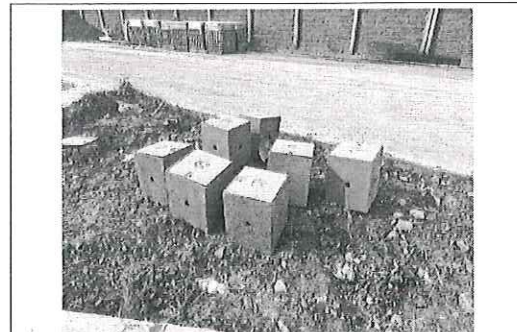
FOTO No. 5: REGISTROS PARA POSTES DE LUMINARIAS FOTOGRAFIA TOMADA EL DIA 31 DE DICIEMBRE DE 2025
