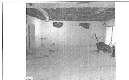
FOTO No. 8: DEMOLICION DE PLAFON UMF 35 FOTOGRAFIA FUE TOMADA EL DIA 23 DE OCTUBRE 2023.
