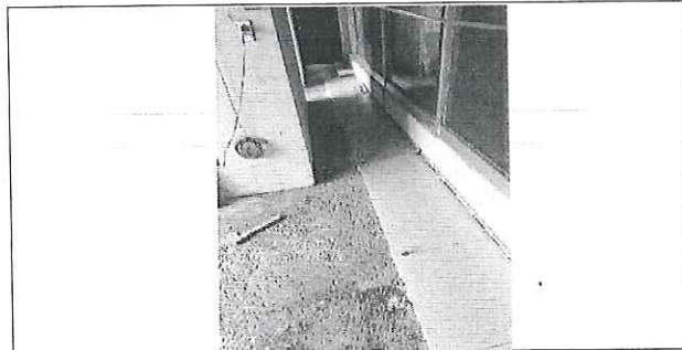
FOTO No. 4: COLOCACION DE PISO CERAMICO EN HGZ 6 ESTA FOTOGRAFIA FUE TOMADA EL DIA 15 DE NOVIEMBRE 2023.
