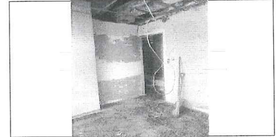
FOTO No. 3 RETIRO DE PLASTICO EN MUROS HGZ 6 FOTOGRAFIA TOMADA EL DIA 05 DE NOVIEMBRE 2023
