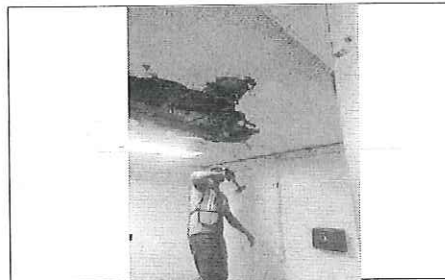
FOTO No. 8: DEMOLICION DE PLAFON UMF 39 FOTOGRAFIA FUE TOMADA EL DIA 11 DE OCTUBRE 2023.
