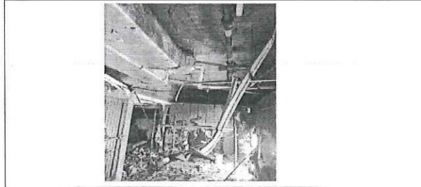
FOTO No. 1: DEMOLICION DE PLAFON HGZ 4 FOTOGRAFIA TOMADA EL DIA 07 DE SEPTIEMBRE 2023
