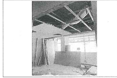
FOTO No. 5: DEMOLICION DE PLAFON UMF 30 ESTA FOTOGRAFIA FUE TOMADA EL DIA 09 SEPTIEMBRE 2023.
