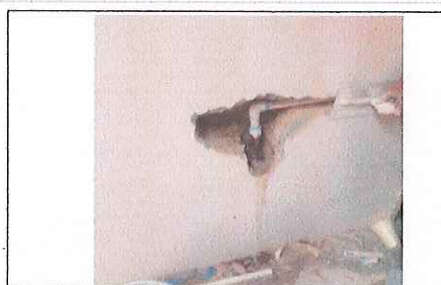
FOTO No. 8: CONEXION DE CONDENSADOS HGZ 33 FOTOGRAFIA FUE TOMADA EL DIA 26 DE SEPTIEMBRE 2023.
