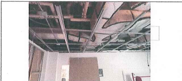
FOTO No. 7: COLOCACION DE SOPORTERIA PARA PLAFONHGZ 33 ESTA FOTOGRAFIA FUE TOMADA EL DIA 28 DE SEPTIEMBRE 2023.
