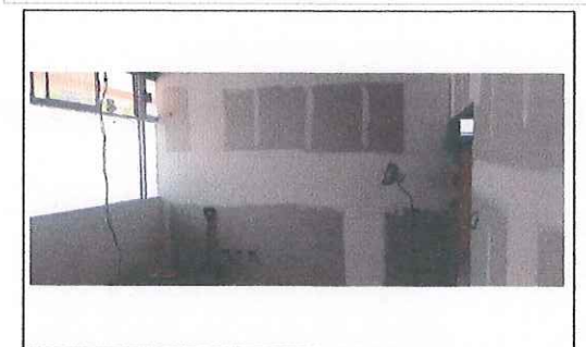
FOTO No. 6 COLOCACION DE MURO DE TABLAROCA UMF 30 ESTA FOTOGRAFIA FUE TOMADA EL DIA 25 DE SEPTIEMBRE 2023.
