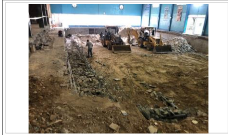
FOTO No. 1: SE CONTINUA CON LOS TRABAJOS CON MAQUINARIA PESADA DENTRO DEL VASO DE LA ALBERCA.
