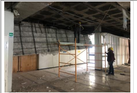
FOTO No. 4: TRABAJOS DE DEMOLICION DE PLAFON EXISTENTE, PENDIENTE EN EL AREA DE PASILLOS DEL ACCESO PRINCIPAL.
