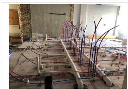
FOTO No. 8: TRABAJOS DE PREPARACION DE TUBERIAS HIDROSANITARIAS CON CONEXIONES PLEX INTEGRADAS .
