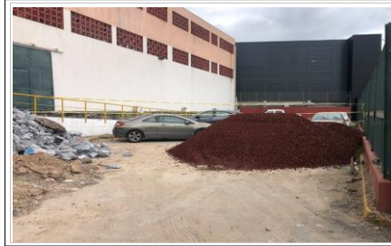
FOTO No. 2: LLEGADA DE MATERIAL PARA USAR EN EL MEJORAMIENTO DEL RELLANO DE LA ALBERCA, EN LOS NIVELES SOLICITADOS DE PROYECTO. YA EN OBRA EN EL AREA DE APILE Y CARGA DE RETIRO DE ESCOMBRO SECCION OTORGADA POR EL CSS1 PARA USAR DURANTE LA EJECUCION DEL PROYECTO.
