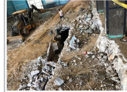
FOTO No. 6: TRABAJOS DE DEMOLICION DE AREA DE TRINCHERAS Y GRADAS EXISTENTES.
