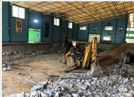
FOTO No. 5: TRABAJOS DE DEMOLICION DE LA ALBERCA SEMI-OLIMPICA Y PREPARACION DE RAMPA PARA EL TRASLADO Y LIMPIEZA DEL ESCOMBRO SOBRANTE.
