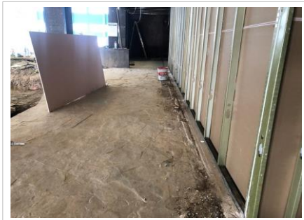
FOTO No. 5: TRABAJOS DE TABLAROCA EN MUROS EN AREA DE OFICINAS Y PASILLO LATERAL.
