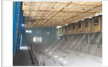
FOTO No. 2: TRABAJOS DE DESCIMBRA AREA DEL VASO DE ALBERCA Y LIMPIEZA .
