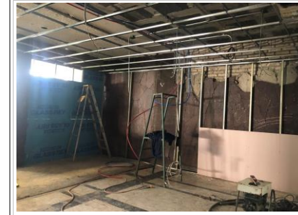
FOTO No. 6: TRABAJOS DE TABLAROCA EN MUROS LATERALES DE AREA DE WC MINUSVALIDOS.
