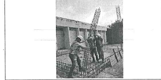
FOTO No. 3 DESCRIPCIÓN DE FOTOGRAFÍA.- COLOCACION DE ACERO DE REFUERZO COLUMNAS. FOTOGRAFIA TOMADA EL DIA 25-10-2023
