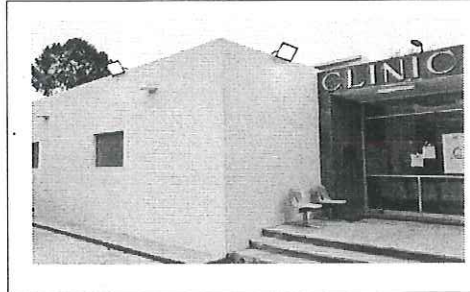
FOTO No. 2: DESCRIPCIÓN FOTOGRAFICA.- GARGOLAS EN FACHADA PARA DESAGUE DE LOSA. FOTOGRAFIA
