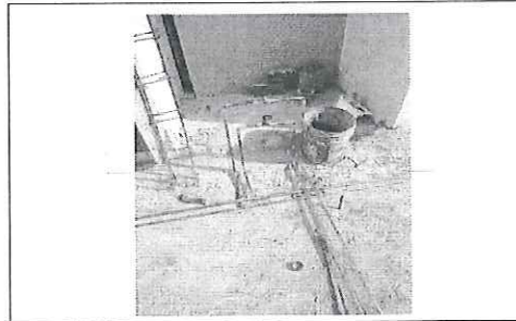
FOTO No. 2: DESCRIPCIÓN FOTOGRAFICA.- TUBERÍA DE COBRE PARA LINEAS DE AGUA FRIA Y CALIENTE. ESTA FOTOGRAFIA FUE TOMADA EL DIA 04-11-2023
