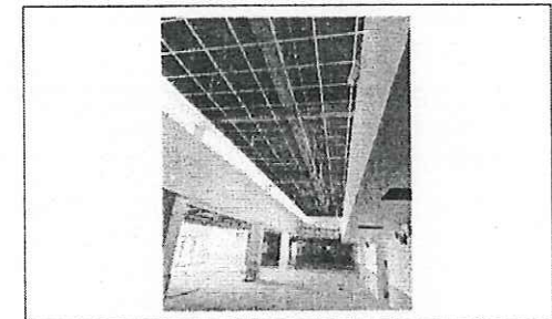
FOTO No. 9: SOPORTERIA DE PLAFON ESTRUCTURADO EN DOBLE ALTURA ESTA FOTOGRAFIA FUE TOMADA EL DIA 31 DE DICIEMBRE DE 2023
