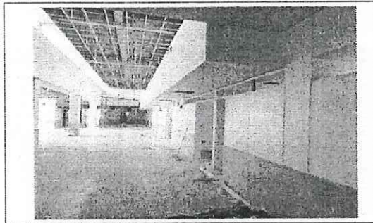
FOTO No. 4: CANCELERIA INTERIOR EN AREAS DE CONSULTORIOS SOPORTERIA DE PLAFON ESTA FOTOGRAFIA FUE TOMADA EL DIA 31 DE DICIEMBRE DE 2023.
