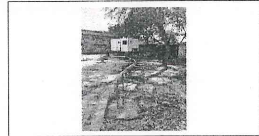
FOTO No. 3: COLADO DE PLANTILLA Y BASE PARA BOLARDOS EXTERIORES FOTOGRAFIA TOMADA EL DIA 31 DE DICIEMBRE DE 2023
