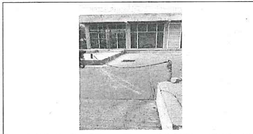
FOTO No. 7: HERRERIA EN CUARTO ELECTRICO ESTA FOTOGRAFIA FUE TOMADA EL DIA 15 DE ENERO DE 2024.
