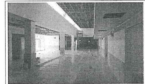
FOTO No. 9: SOPORTERIA DE PLAFON ESTRUCTURADO EN DOBLE ALTURA Y CANCELERIA DE ALUMINIO ESTA FOTOGRAFIA FUE TOMADA EL DIA 15 DE ENERO DE 2024
