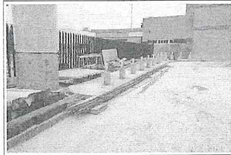
FOTO No. 5: BOLARDOS Y BANQUETAS EN OBRA EXTERIOR ESTA FOTOGRAFIA FUE TOMADA EL DIA 15 DE ENERO DE 2024.
