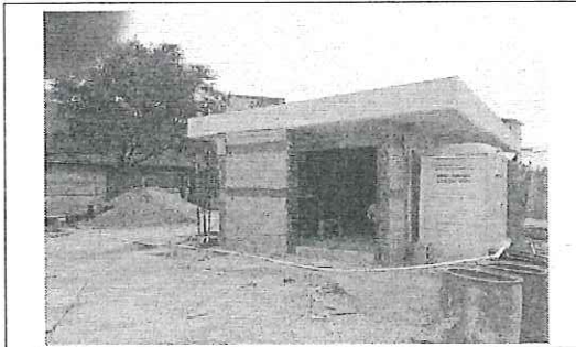
FOTO No. 4: AMPLIACION DE SUBSTACION ELECTRICA ESTA FOTOGRAFIA FUE TOMADA EL DIA 15 DE ENERO DE 2024.
