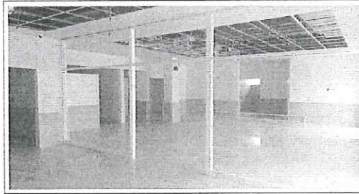
FOTO No. 2: CANCELERIA INTERIOR EN SALA DE ESPERA DE ATENCION MEDICA CONTINUA FOTOGRAFIA TOMADA EL DIA 15 DE ENERO DE 2024
