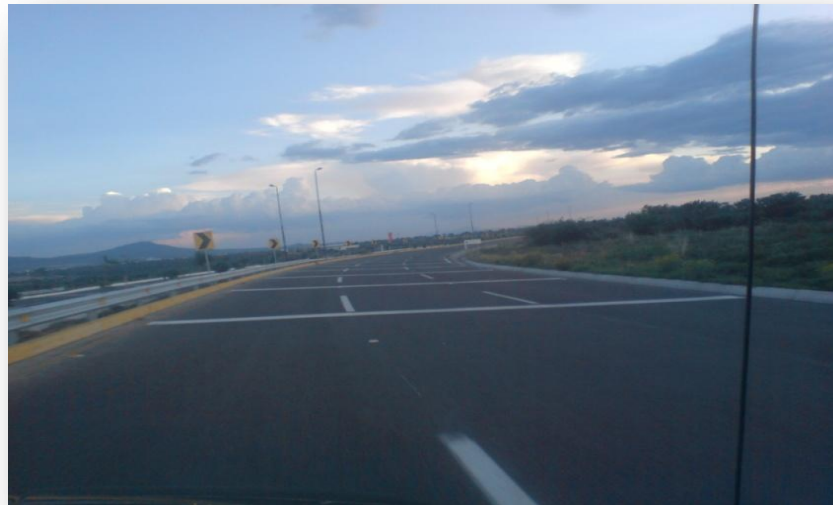
Figura 4. 33 Estado del pavimento Circuito Vial Universidades
