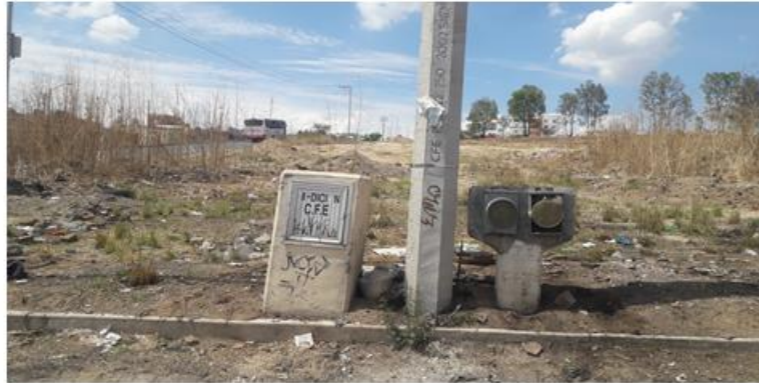
FOTOGRAFIA 01 Preparación en el predio sobre la calle de Asia, para efectuar la conexión respectiva al inmueble que se construya.
