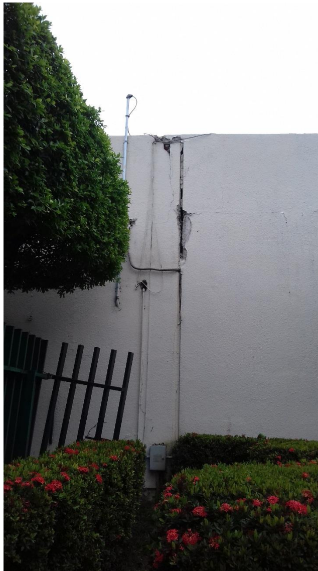
Fotografía No. 17: Se observan fisuras en juntas constructivas y aplandados, no representan daño estructural.
