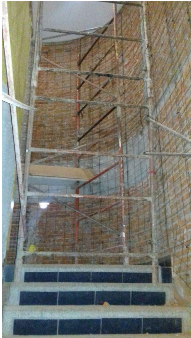
Fotografía No. 11: Se observa desprendimiento de aplanado de mortero en el espacio disponible para la escalera.
