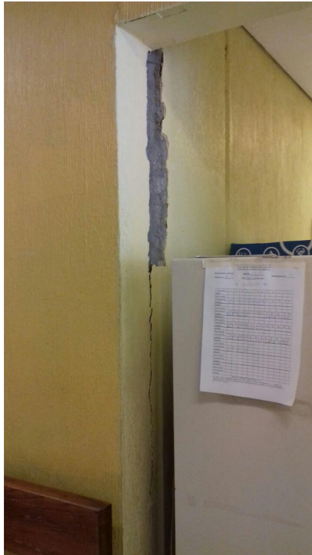
Fotografía No. 4: Se observan fisuras en juntas constructivas y aplanados, no representan daño estructural.
