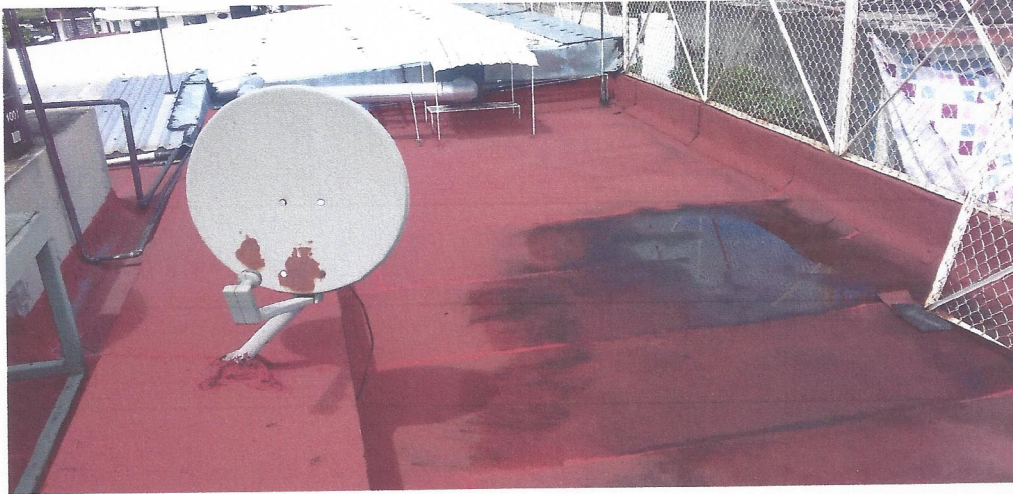
Encharcamiento en Área de Azotea
