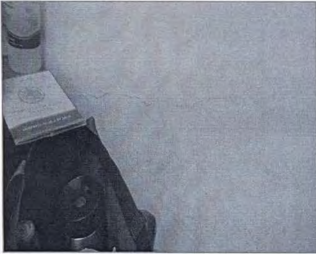
Fisura en cubículo de área de inhaloterapia en el 1er nivel del edificio de hospitalización.
