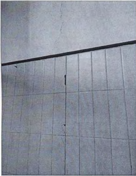
Fisura en bodega del área de nutrición y dietética, en sótano del edificio de hospitalización.
