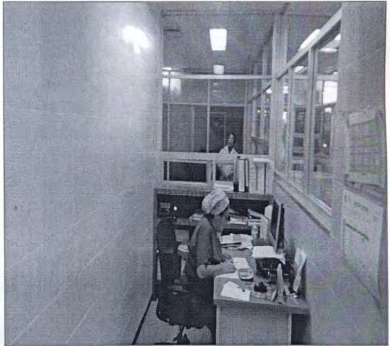
Muro con azulejos desprendidos en área de jefatura de C.E.Y.E. del 1er nivel del edificio anexo a hospitalización
