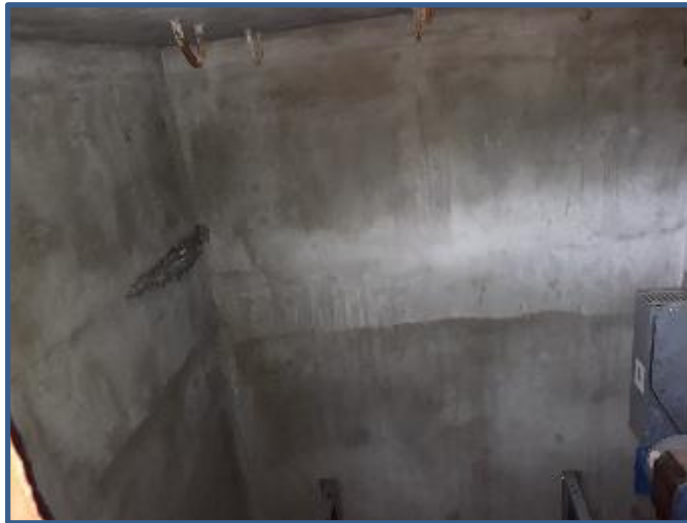
GRIETAS EN CUARTO DE MAQUINAS.
