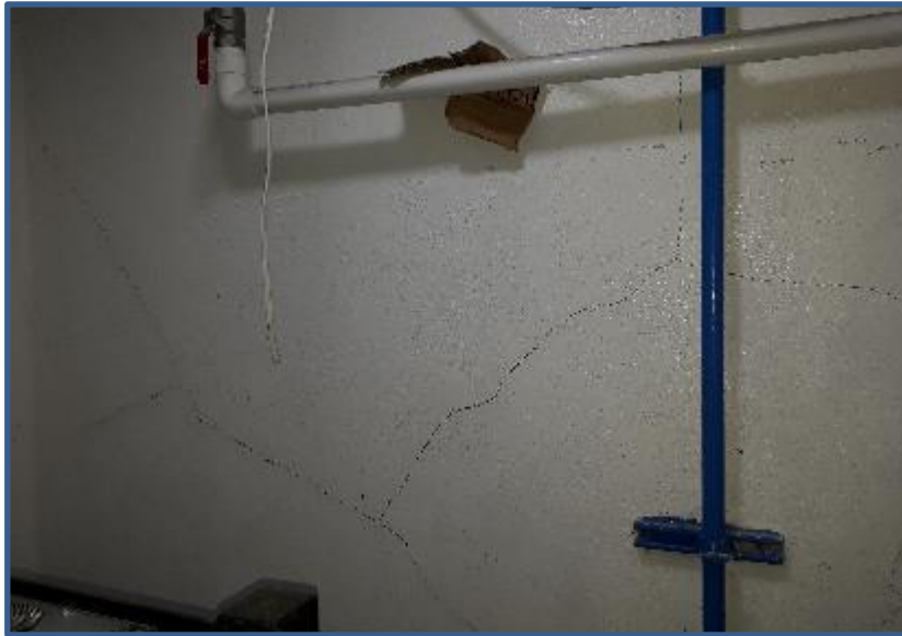
AGRIETAMIENTOS Y DESPRENDIMIENTOS.
