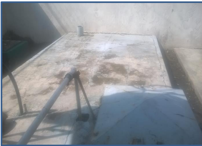
GRIETAS EN TAPA DE CIATERNA.
