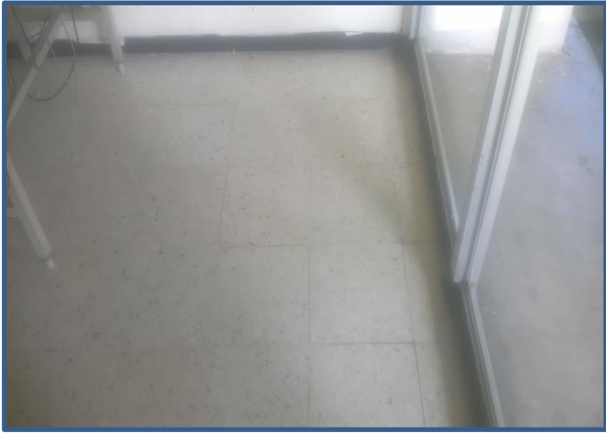
GRIETA EN LOSETAS DE PISO
