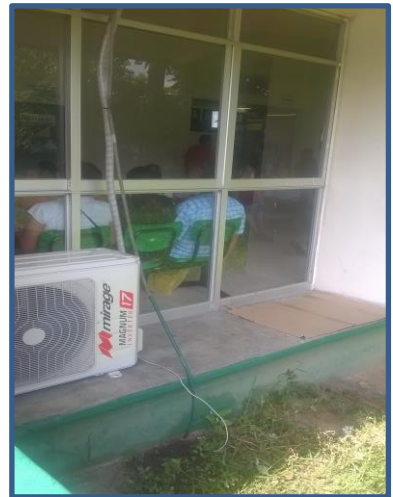
EQUIPOS DE AIRE DAÑADOS.
