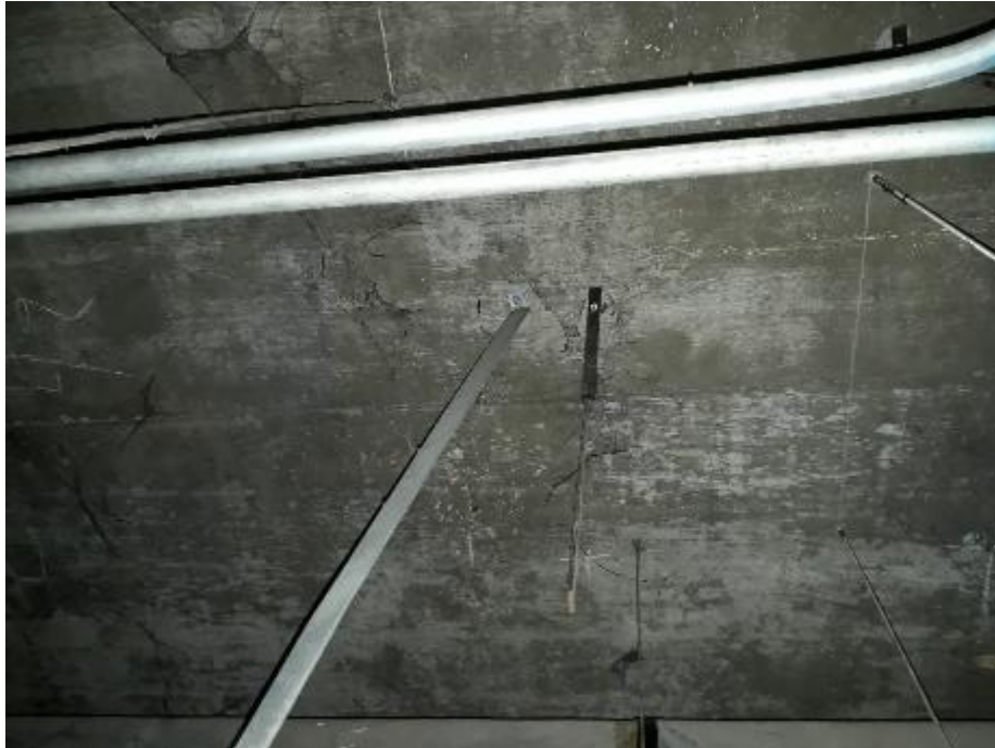
ELEMENTOS ESTRUCTURALES INTEGROS.
