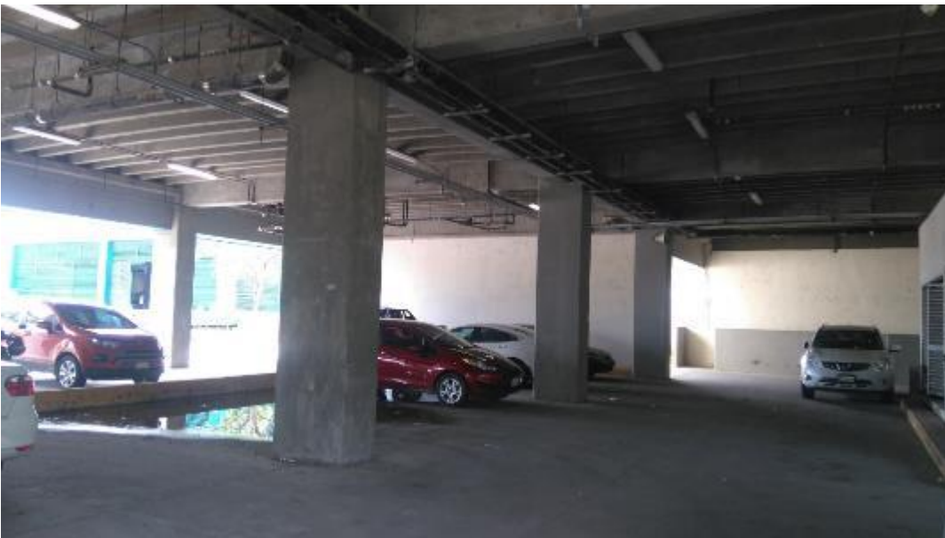
ELEMENTOS ESTRUCTURALES INTEGROS.
