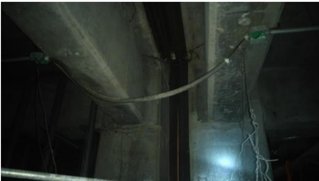
ELEMENTOS ESTRUCTURALES INTEGROS.
