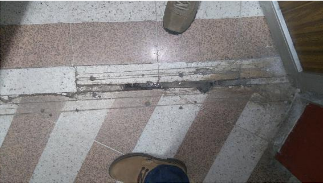
JUNTAS DE CONSTRUCCION EN MAL ESTADO
