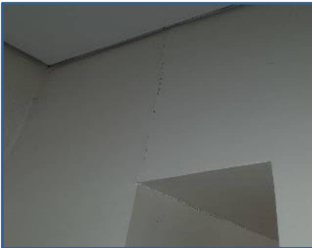
GRIETAS MINIMAS EN MUROS
