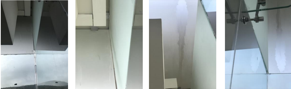
FALLA DE TENSION DIAGONAL EN VIGAS DE ACOPLAMIENTO EN MUROS DE CORTANTE EN CORONA Y ASENTAMIENTOS DIFERENCIALES POR FUERZAS DE CORTANTES OCASIONADOS POR EL SISMO PASILLO INTERNO SEGUNDO NIVEL
