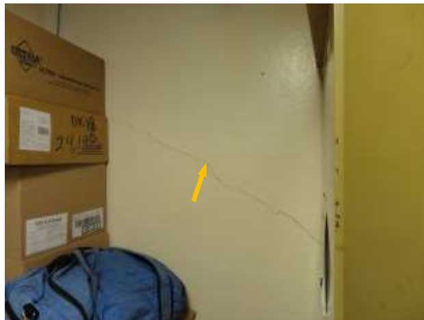
Foto 6. Fisura por asentamiento.
