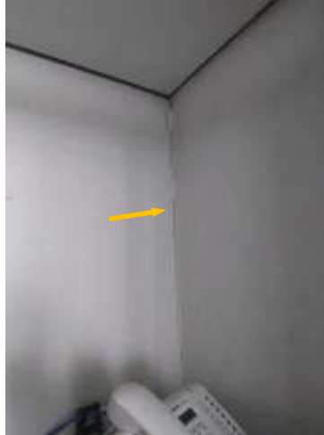
Foto 5. Fisura en muro de tablaroca
