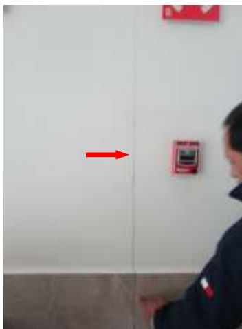
Foto 6. Fisura en junta fría a nivel de aplanado
