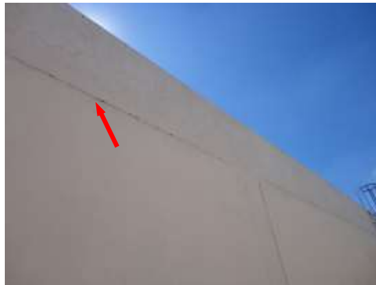
Foto 6. Fisura en faldón
