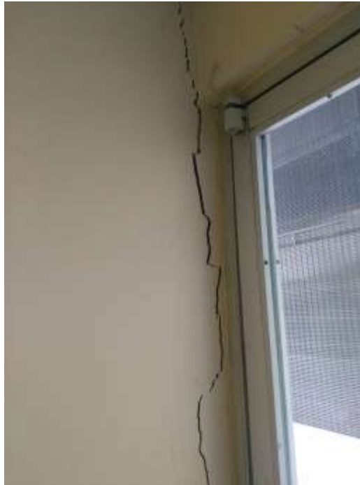
FOTOGRAFÍA 3. GRIETA VERTICAL EN MURO EN LA ZONA DEL PASILLO DE LA SALA DE URGENCIAS.
