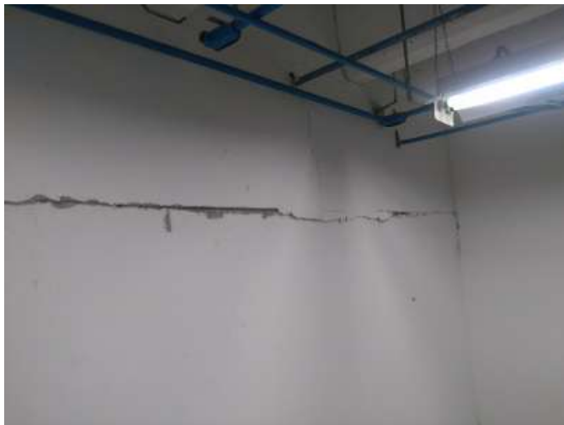
FOTOGRAFÍA 8. FRACTURA HORIZONTAL EN MUROS A BASE DE PANEL
