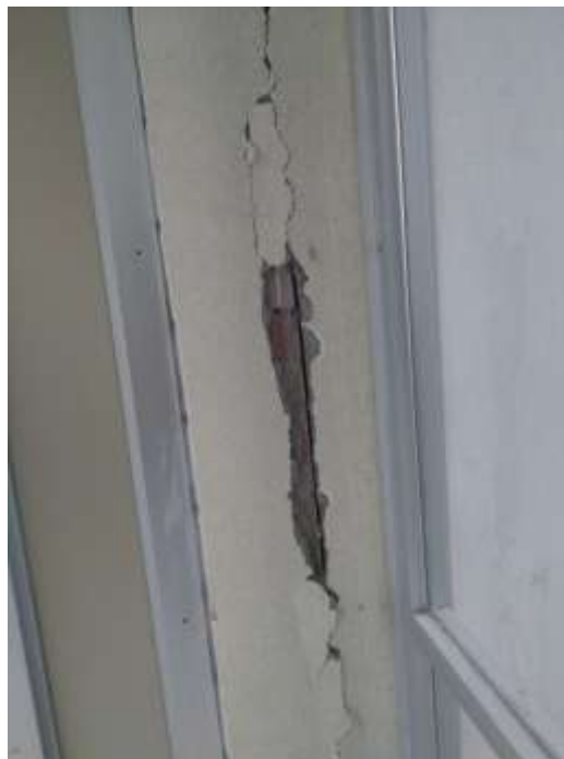
FOTOGRAFÍA 4. GRIETA VERTICAL EN MURO EN LA ZONA DEL PASILLO DE LA SALA DE URGENCIAS.
