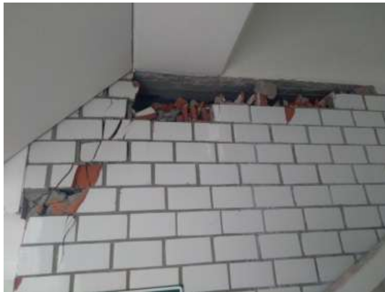
FOTOGRAFÍA 6. DESPRENDIMIENTO Y SEPRACIÓN DE MAMPOSTERIA EN MUROS NO ESTRUCTURALES EN LA ZONA DE ESCALERAS DEL ACCESO PRINCIPAL.
