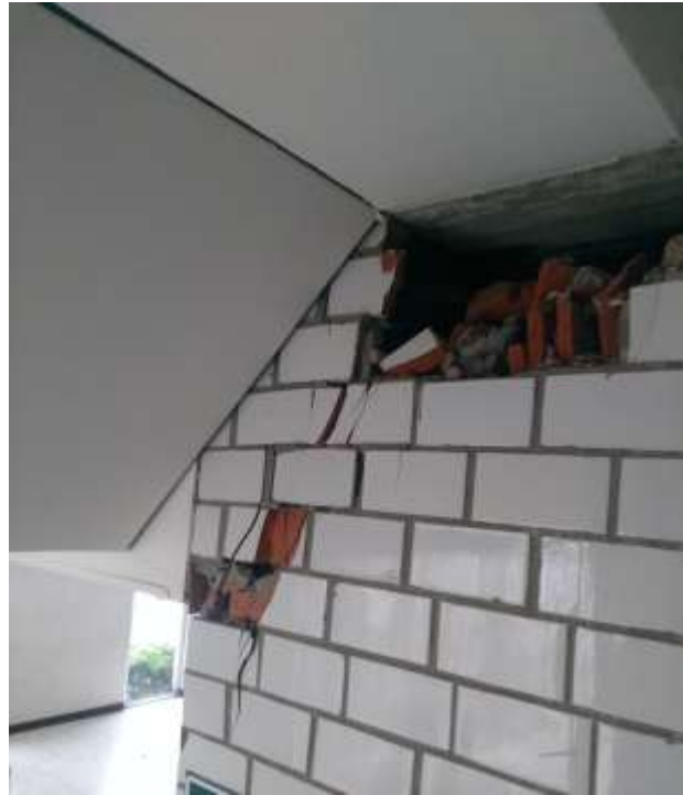
FOTOGRAFÍA 7. DESPRENDIMIENTO Y SEPRACIÓN DE MAMPOSTERIA EN MUROS NO ESTRUCTURALES EN LA ZONA DE ESCALERAS DEL ACCESO PRINCIPAL.
