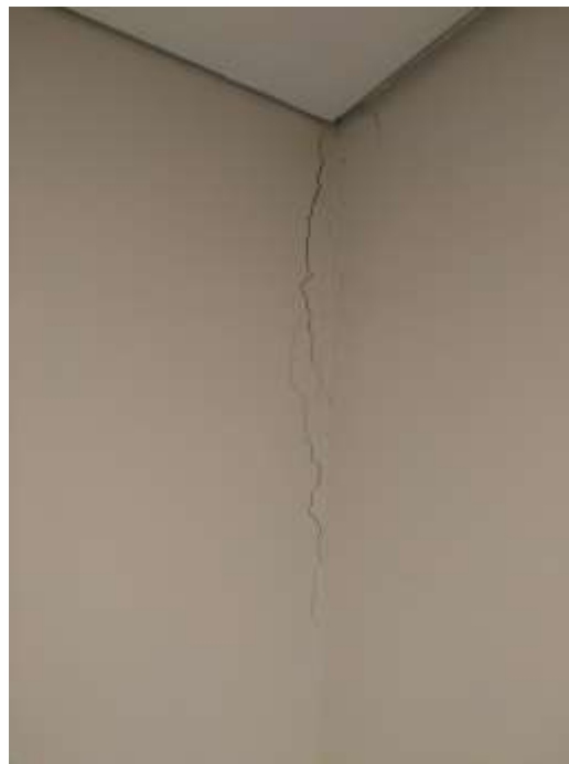
FOTOGRAFÍA 2. GRIETA VERTICAL EN MURO LATERAL.
