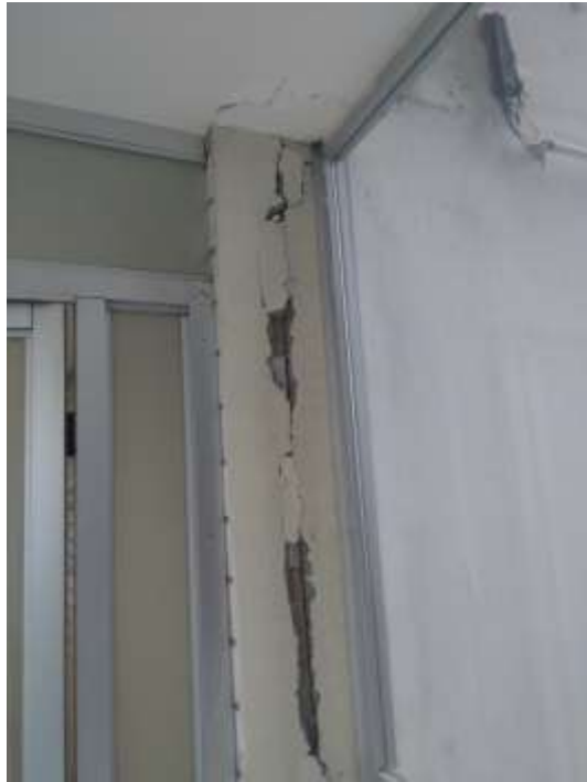
FOTOGRAFÍA 5. GRIETA VERTICAL EN MURO EN LA ZONA EXTERIOR DE LA SALA DE URGENCIAS.
