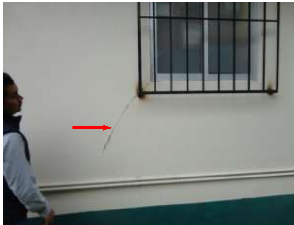
Foto 7. Fisura en aplanado debida a un asentamiento, y a la carencia de adecuado confinamiento y refuerzo del muro
