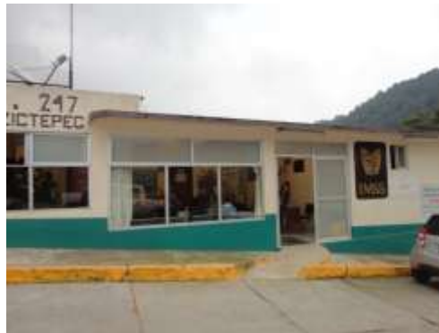
Foto 6. Vista de la fachada principal de la UMF No. 247 – San Pedro Zictepec. No se aprecia ningún tipo de daño
