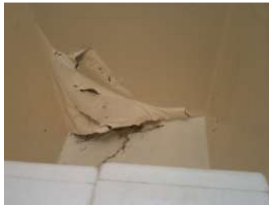
Foto 5. Daño por humedad en plafond de tablaroca
