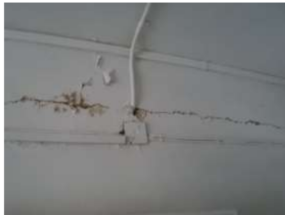
Foto 6. Fisura en muro
