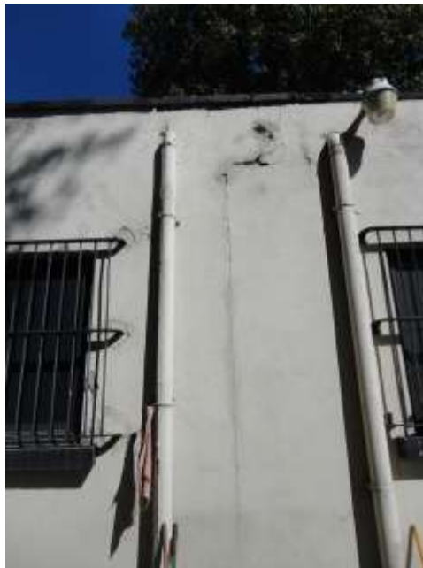
Foto 4. Fisura en junta constructiva
