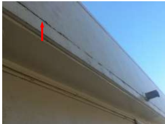
Foto 6. Fisura en junta constructiva de faldón
