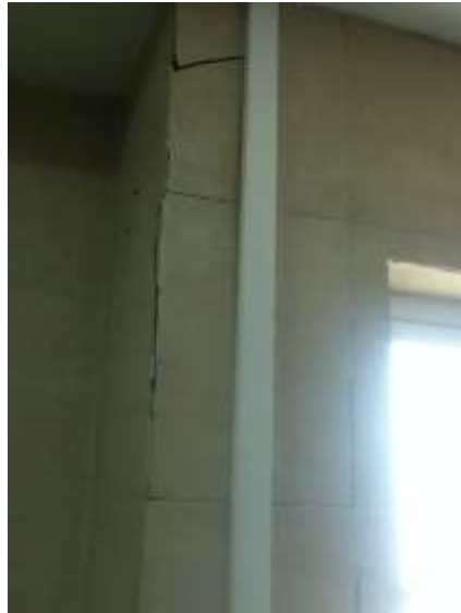
Foto 7. Loseta de recubrimiento desprendida
